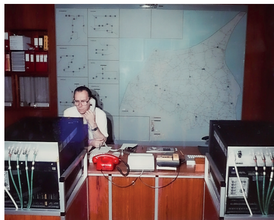
Fjernstyringskontrol-system i vagten
